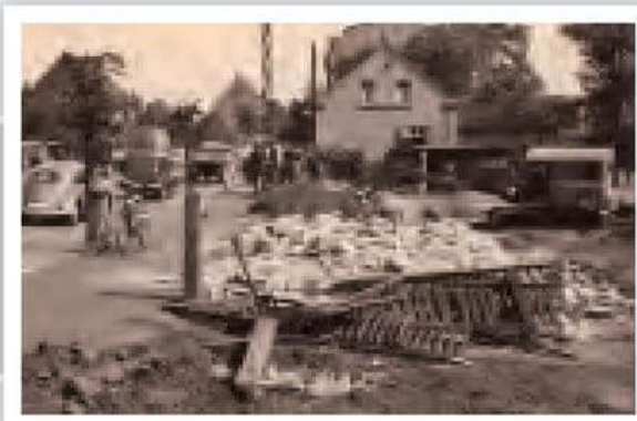
Der Abbruch der dort stehenden Häuser. In diesem Fall, der Verkaufsladen der Gärtnerei Möhlenkamp
